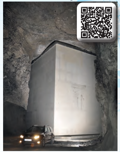
Einbau von rückverankerter Schalung von fast 600 Quadratmetern, damit ein 1900 m3 großer Betonquader mit einer mehr als 100 Meter langen Pumpenleitung in 72 Stunden am Stück gegossen werden konnte.
